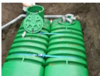
⑦ Cuves mises en batterie
